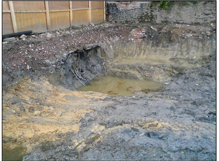
Imagen 18: Contaminación del suelo por depósitos subterráneos de almacenamiento de alquitrán.
